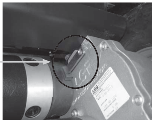
Figur 22 Frakoblet, højre side.
