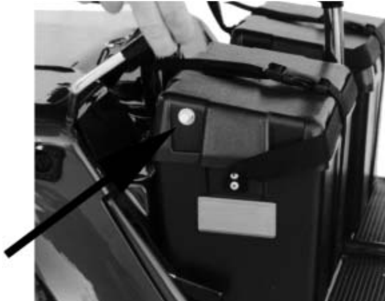
Figur 21 Der sidder 1 sikringsknap på ydresiden af hver batterikassen, dvs. 2 sikringsknapper i alt.
